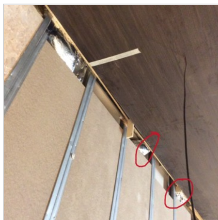
1 - CVCD - 1 - CVCD Réseaux soufflage double flux endommagés par la pose des habillages.
