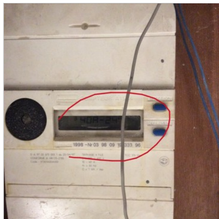
Maitre d'ouvrage - 2 - Electricité Courants Forts et Faibles Le changement de puissance souscrite n'a pas encore été réalisé et le devra avant mise en service
