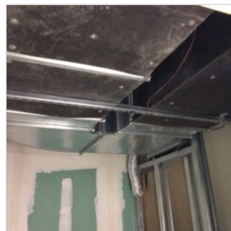
1 - CVCD - 1 - CVCD Pièges à sons au dessus des WC
