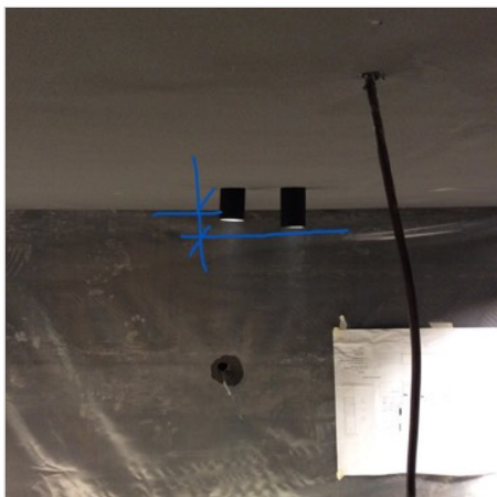
2 - Electricité Courants Forts et Faibles - 2 - Electricité Courants Forts et Faibles Les spots seront à régler avant livraison
