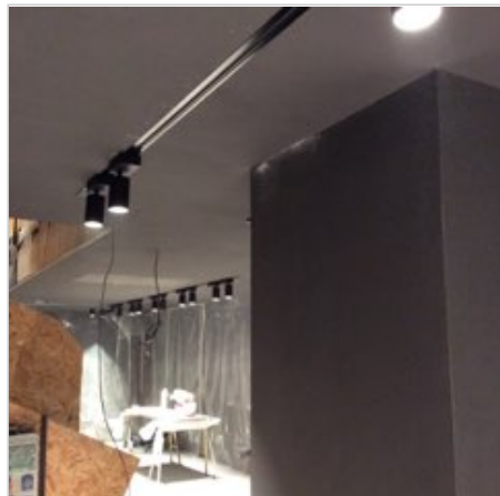
2 - Electricité Courants Forts et Faibles - 2 - Electricité Courants Forts et Faibles Eclairages sous sol zone escalier
